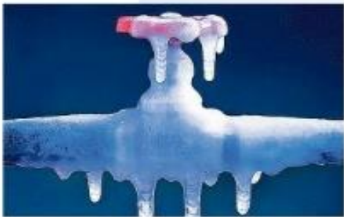
Водопроводы и канализация
